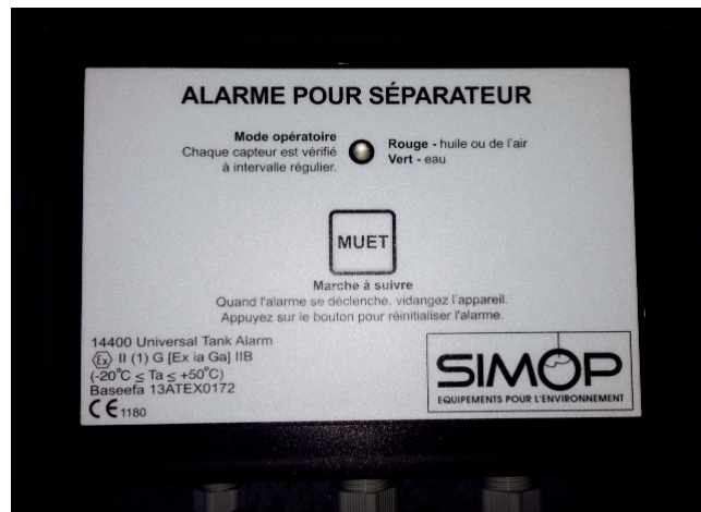
Boîtier alarme SIMOP
