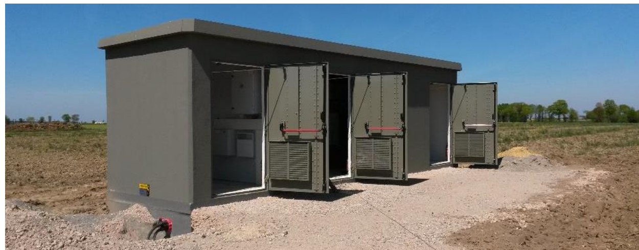
Photo 56 : Exemple de poste de livraison prévu sur le projet
