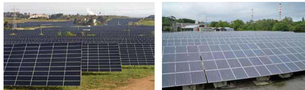
Photo 2 : installations fixes au sol
