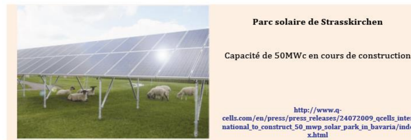
Figure 22 : Ferme photovoltaïque combinée avec un élevage ovin (Rapport Solaire / Agriculture de Quattrolibri)
